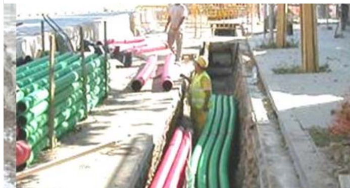
NOVES XARXES D'ENERGIA I TELECOMUNICACIONS
